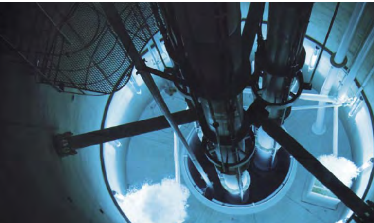
Trinkwasserfassung Hardhof, Zürich
