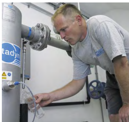
Probenahme im Pumpwerk
