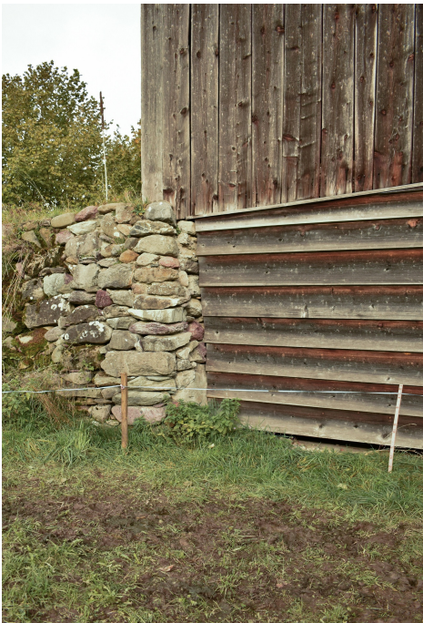
Feldscheune Burstel, Rampe auf trocken geschichteten Natursteinen, Übergang zur Hocheinfahrt, Ansicht von SW, 04.11.2022 (Bild Nr. D100692_95).
