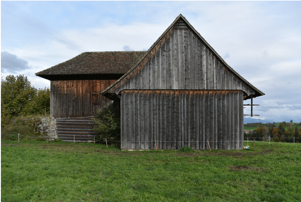
Feldscheune Burstel, Ansicht von SW, links die Hocheinfahrt, davor die Rampe, 04.11.2022 (Bild Nr. D100692_93).
