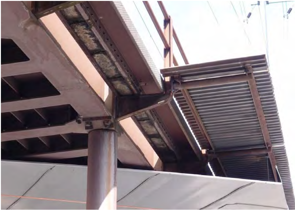
Strassenunterführung Badenerstrasse, Pendelstützen, dahinter die neuen Schutzvorrichtungen für die Fahrleitung der Limmattalbahn, 10.08.2019 (Bild Nr. D101354_47).
