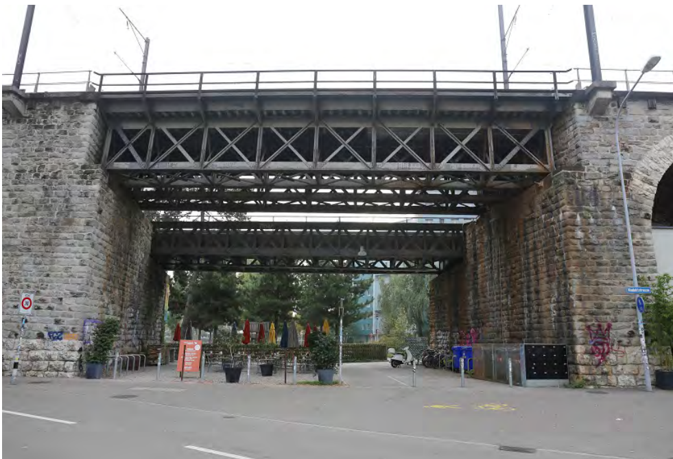
Wipkinger Viadukt, Hausteinbögen mit Strassenunterführungen (261AUVIADUKT00001), Strassenunterführung Neugasse, Ansicht von W, 20.10.2018 (Bild Nr. D101353_69).
