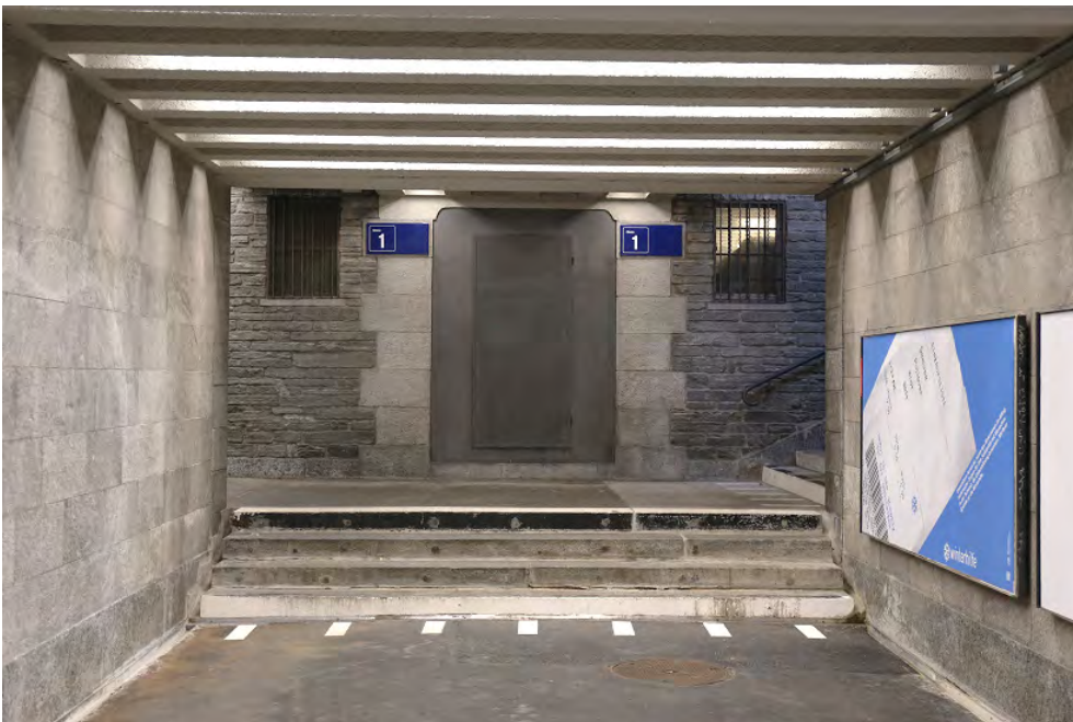
Bahnhof Zürich Enge, Personenunterführung Süd (261ENUNTERF01270-2), Aufgang zu Perron 1, 18.10.2018 (Bild Nr. D101354_26).
