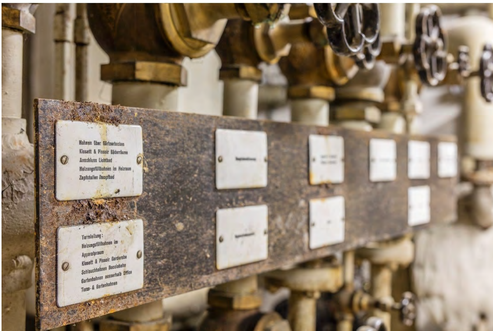
Frei- und Hallenbad mit Gartenanlage, Hallenbad- und Sporttrakt, bauzeitliche technische Ausstattung im UG, 06.06.2017 (Bild Nr. D101532_54).
